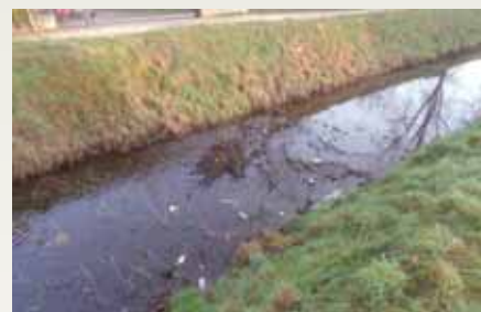
Zaśmiecony Kanał Wawerski z widoczną „tarną” z gałęzi
