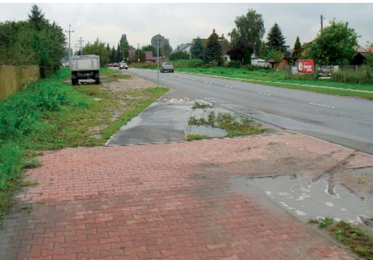
Niebezpieczny kraniec ścieżki rowerowej
