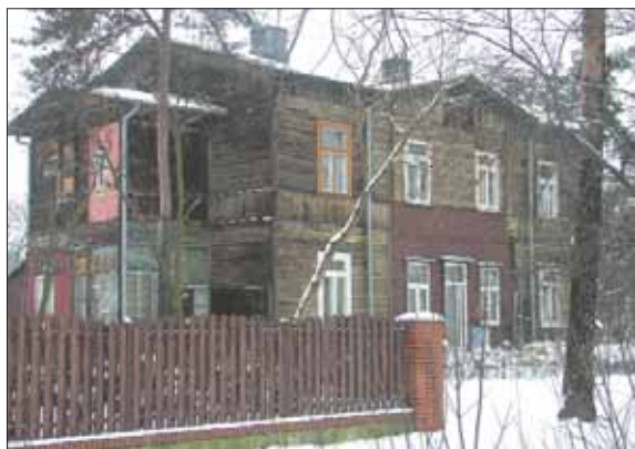
Czekający na samounicestwienie „pekin” w fatalnym stanie technicznym – Radość, ul. Patriotów
